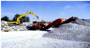
建筑级骨料再生生产线
